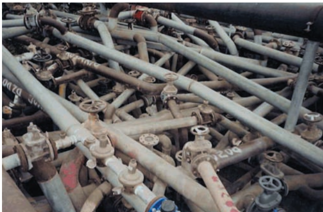
Rys. 7. Przykład niewłaściwie zaprojektowanej instalacji wymagającej uproszczenia
