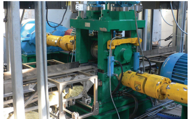
Rys. 1. Widok klatki walcowniczej wraz z samotokami podawczo-odbiorczymi
