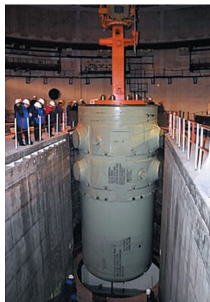
Rys. 6. Trzecia bariera ochronna reaktora: wysokościennej stalowy korpus reaktora
