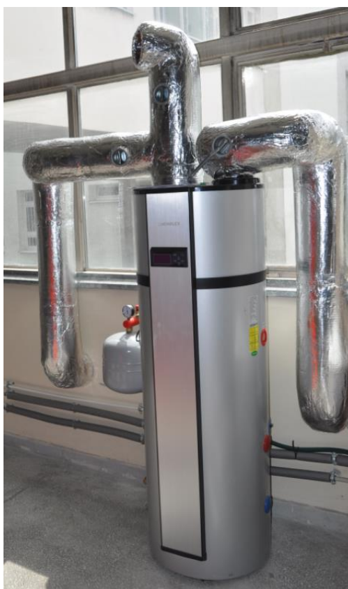
Rys. 6. Prototypowa instalacja pompy ciepła PCWU 200K-2.3 kW z zasobnikiem 200 litrów zastosowana podczas badań. Źródło: zasoby własne
