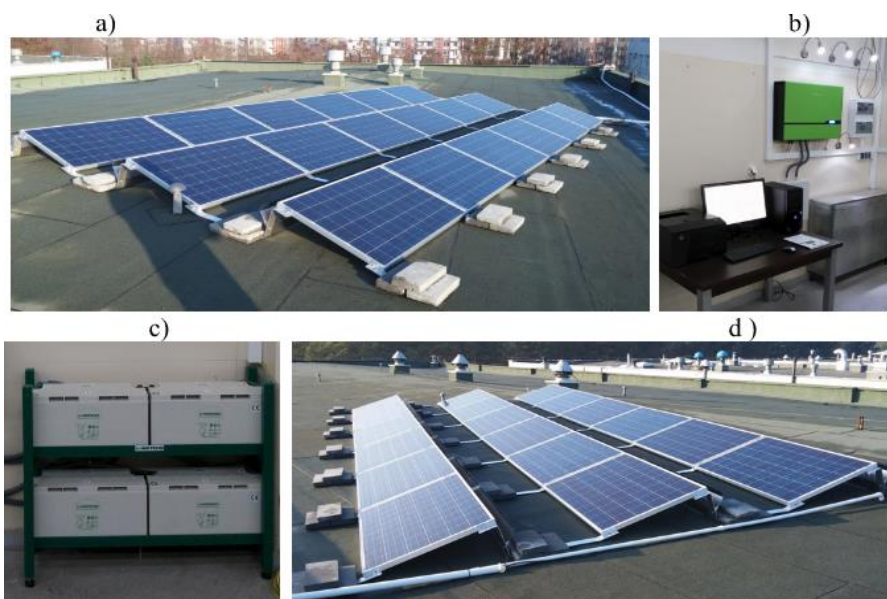
Rys. 4. Instalacja fotowoltaiczna na WIM UTP w Bydgoszczy wykorzystana do zasilania instalacji pompy ciepła: a, d - moduły PV, b - system pomiarowy, c - bank akumulatorów. Źródło: labioze.utp.edu.pl
