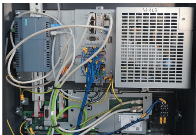
Rys. 3. Zainstalowany MindConnect IoT 2040 ze sterownikiem SINUMERIK 828D
